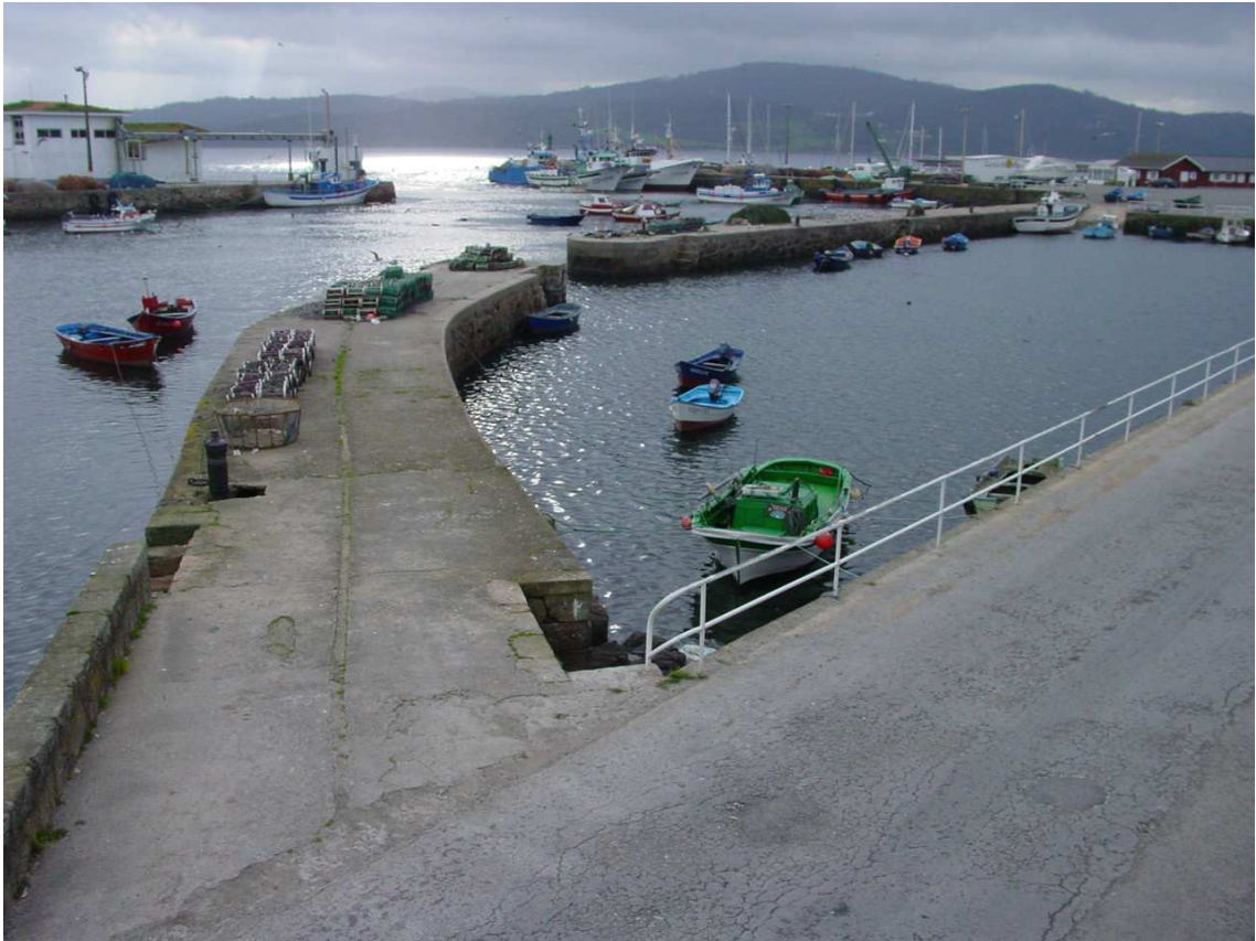
Estado dos diques orixinais do porto antes da súa remodelación
